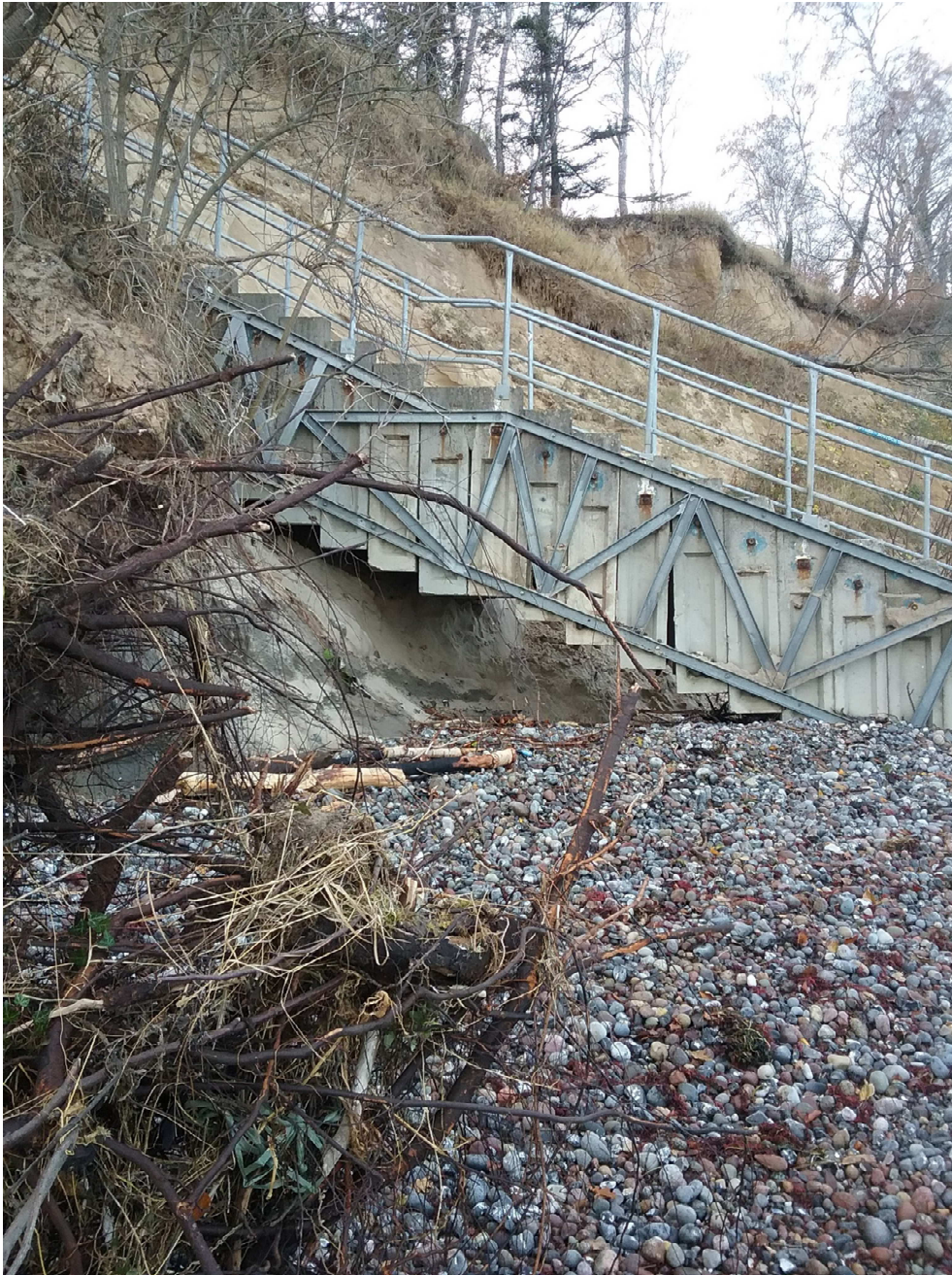
Unterspülte Treppe bei Dünenaufgang 38 nahe der Wilhelmshöhe
